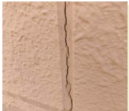
シールの劣化によるひび割れ
